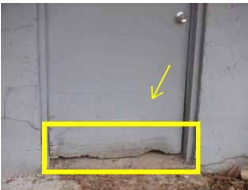
Photo 25-2 Bottom door rot
